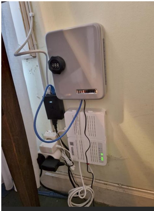
Bredbandsswitch och router
